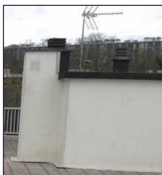
Conduits shunts existants
