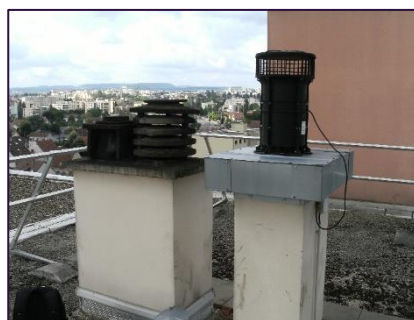
Exemple de tourelles d'extraction
