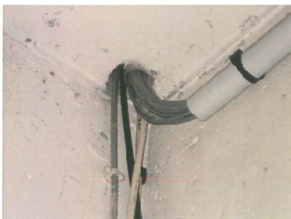
8225_PDC C Batiment C Point de remontee en fourreau
