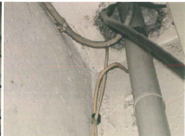
8150_PDC A Batiment A Point de remontee en fourreau
